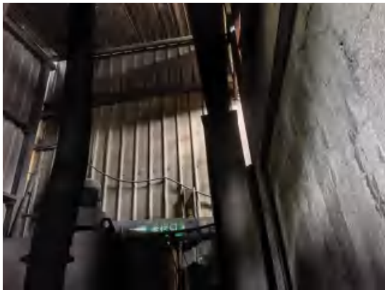
抛丸废气布袋除尘装置
