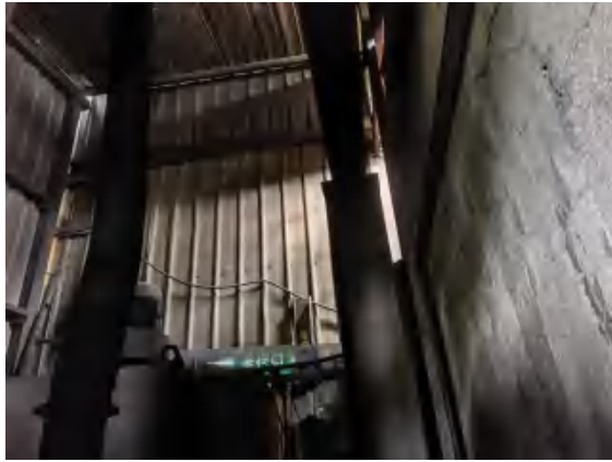
抛丸废气布袋除尘装置
