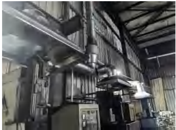
DA002 电火花废气排气筒
