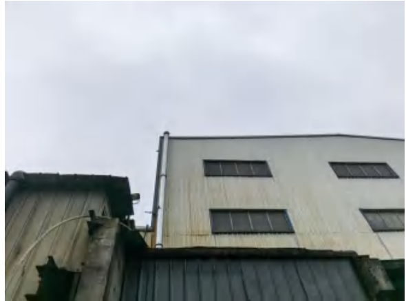
DA001 抛丸废气排气筒
