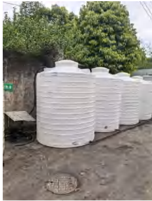
初期雨水收集池、事故应急罐组及水泵
