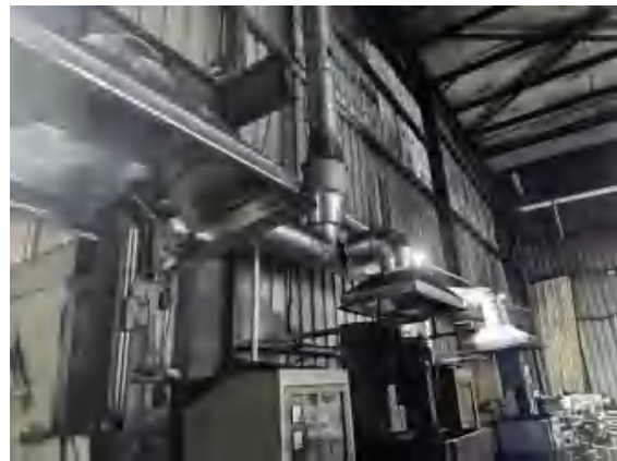
DA002 电火花废气排放口
