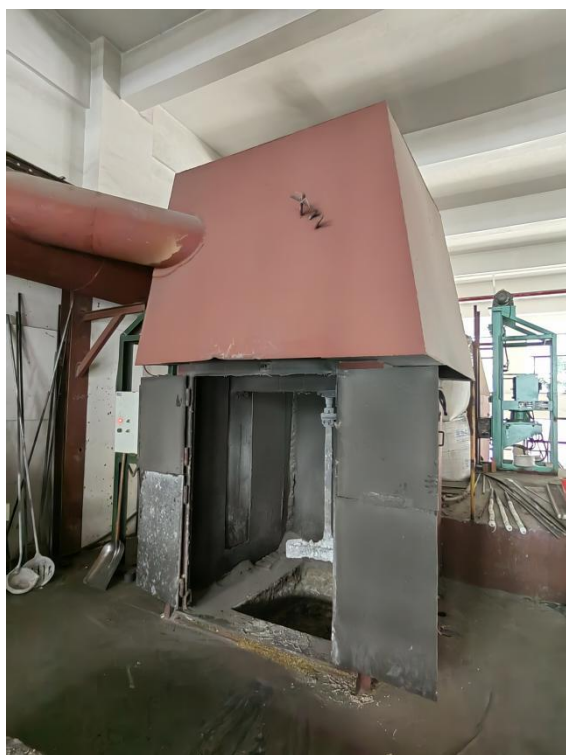
感应炉废气集气措施
