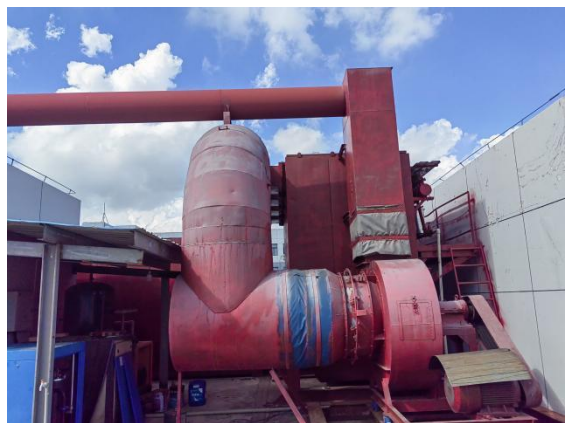
废气处理设施
